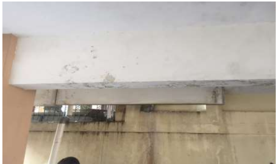
Gambar 4. Terlihat kebocoran pada lorong bawah menuju parkir mobil belakang dan kantin.
