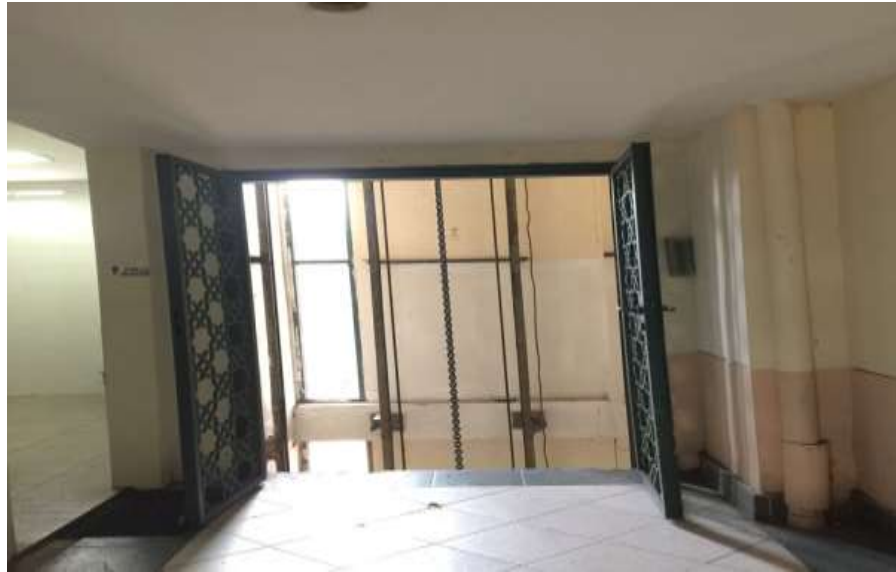
Gambar3. Pintu Lift yang rusak
