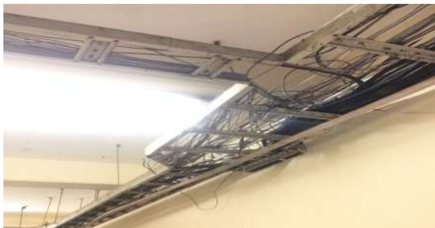
Gambar 3. Terlihat banyak kabel yang tidak tersusun rapi yang ditakutkan mengakibatkan korslet.
