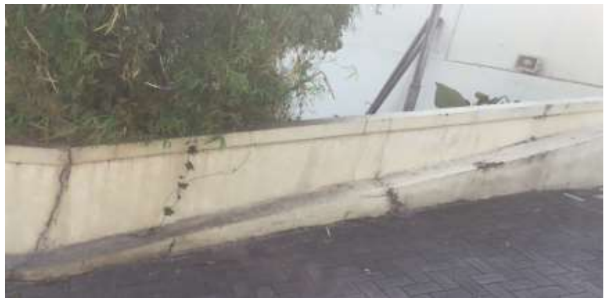
Gambar 6. Terlihat tembok pembatas yang sudah retak didekat turunan menuju apangan basket.
