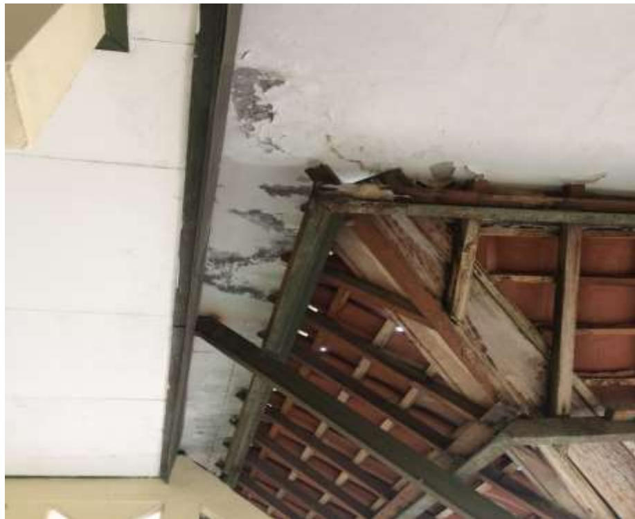
Gambar 6. Terlihat kebocoran di Lt4 gedung FPSB.
