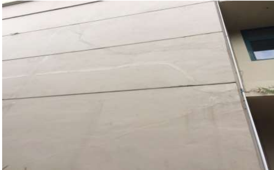
Gambar 5. Keretakan tembok luar gedung FPSB Prodi Ilmu komunikasi.
