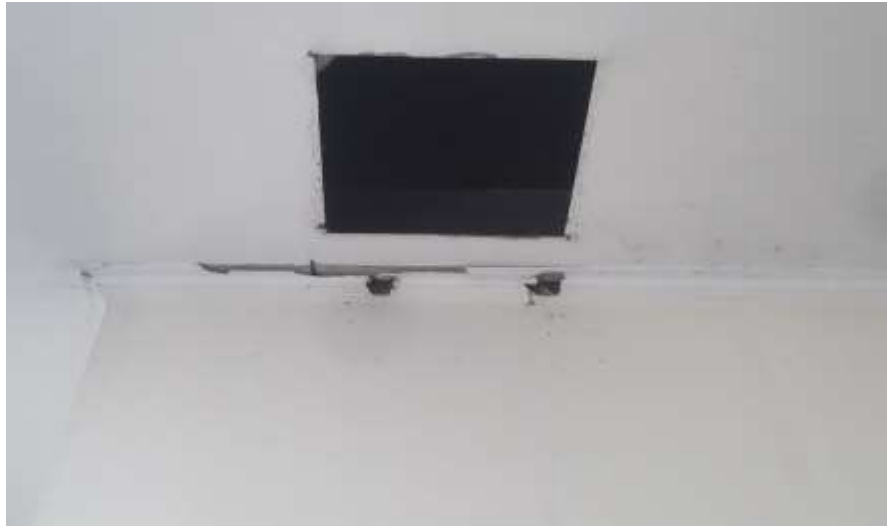
Gambar 8. Terlihat bolong dan retaknya asbes di Lt 3 dekat TS3/4.
