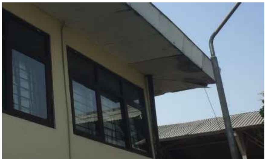
Gambar 7. Terlihat asbes yang sudah rapuh dan hamper jatuh dipojok utara lapangan basket.
