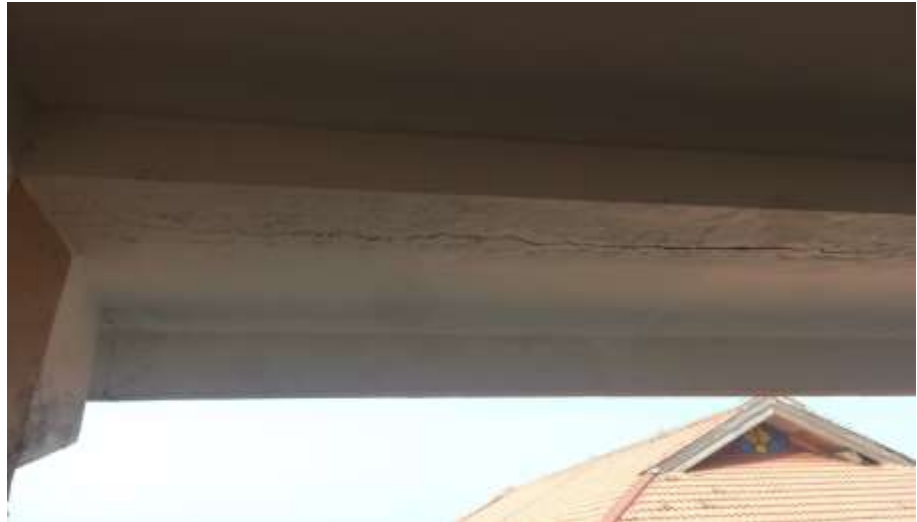
Gambar 3. Terlihat keretakan ditembok bagian atas di lt3 depan ruang siding
