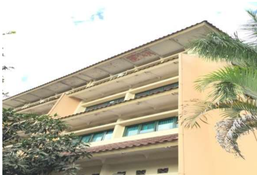
Gambar 1. Menunjukkan kebocoran disisi luar atap Fakultas
