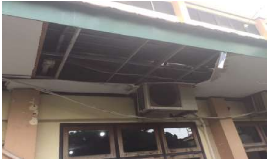
Gambar 5. Terlihat asbes yang jebol dan bolong di parkir motor belakang.
