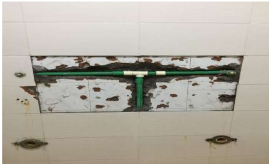
Gambar 2. Bekas bongkaran pipa tidak lagi ditutup
