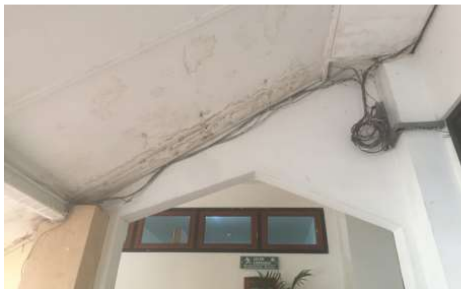
Gambar 2. Kebocoran cukup parah di lt 2 didekat tangga menuju masjid.
