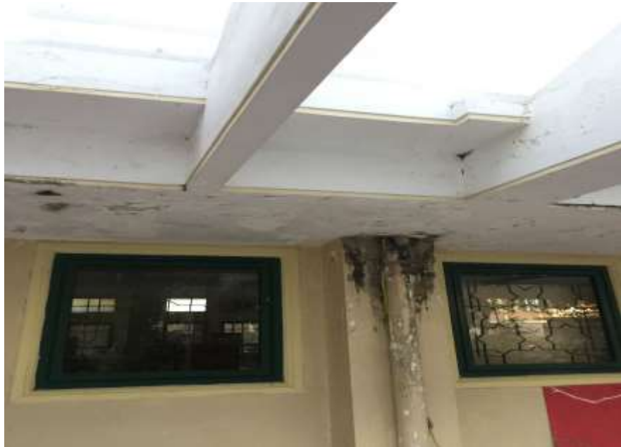
Gambar 1. Terlihat kantin bawah FTSP mengalami kebocoran yang cukup parah
