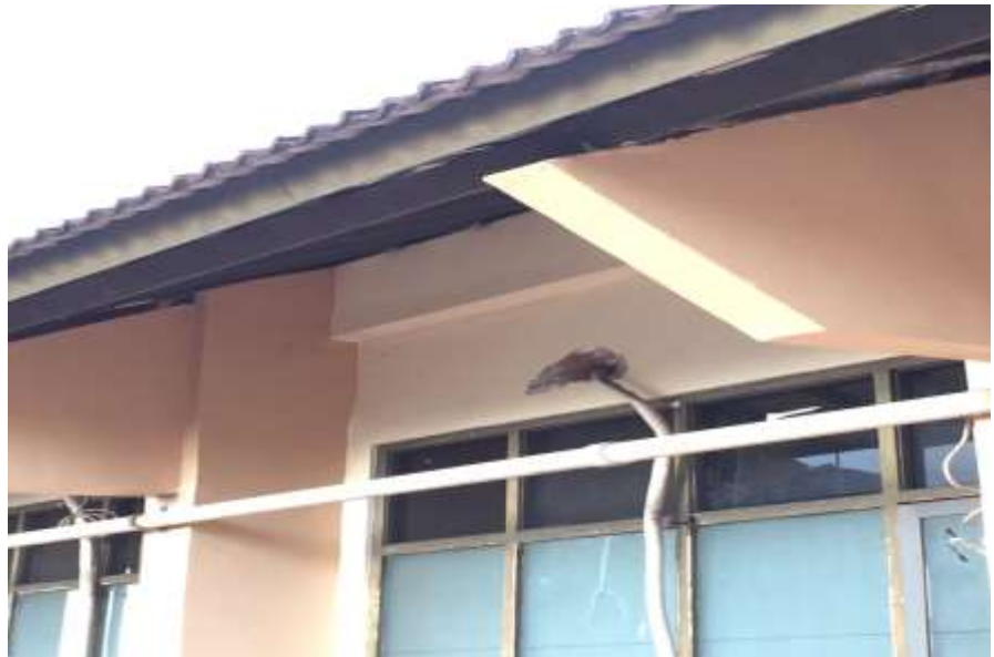
Gambar 2. Penyusunan kabel tidak rapih, dibagian luar tembok kelas.
