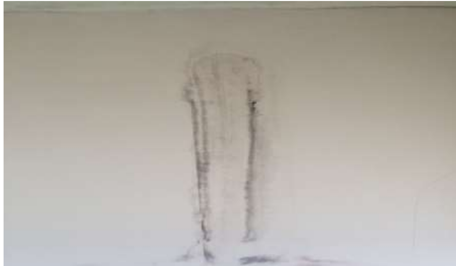
Gambar 1. Terlihat Kebocoran pada tembok di dekat mesjid FE.
