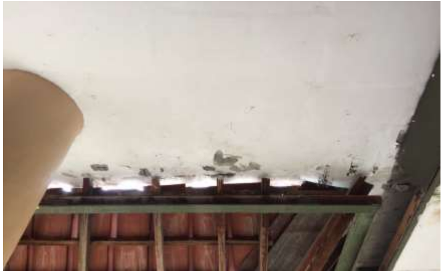
Gambar 3. Terlihat kebocoran di pojok selatan gedung FPSB lt 3
