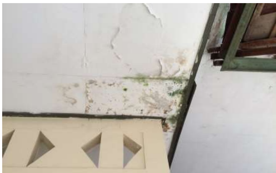
Gambar 2. Terlihat kebocoran yang di lt 3 FK sayap timur.
