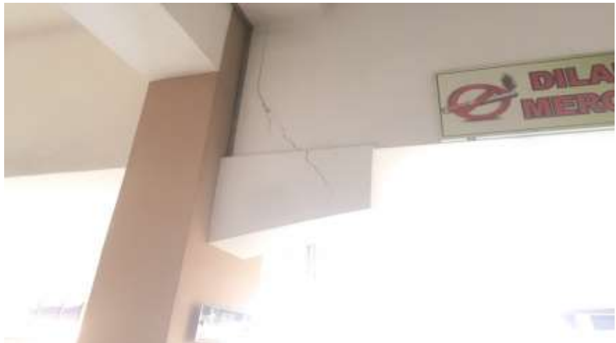
Gambar 9. Terlihat tembok tiang yang retak di Lt 2 depan TS2/12
