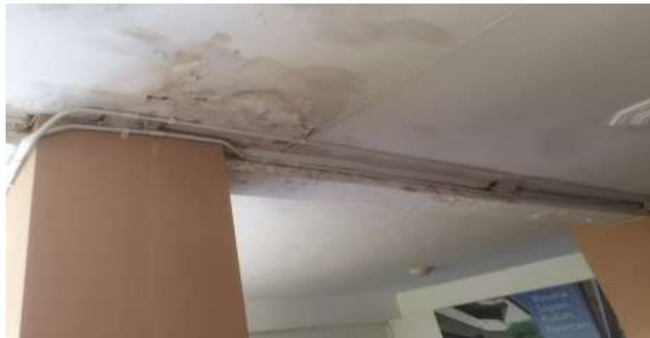
Gambar 1. Terjadi kebocoran yang cukup parah di lt2 didepan TS2/5.
