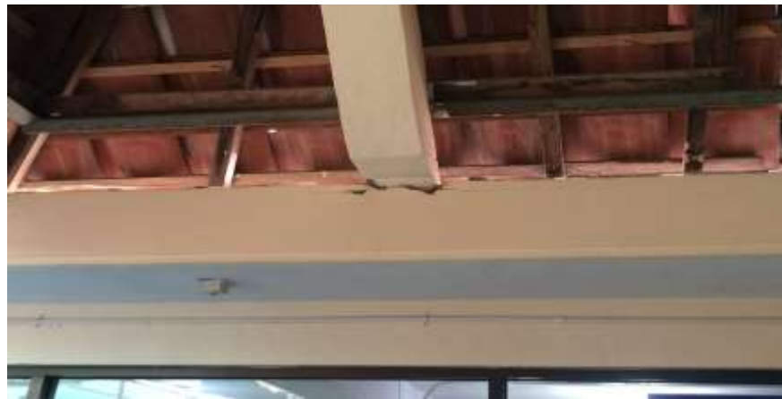
Gambar 1. Terlihat retakan pada tiang penyangga di lt3 FPSB prodi Ilmu komunikasi
